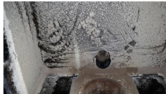
Limpeza da câmara de combustão
