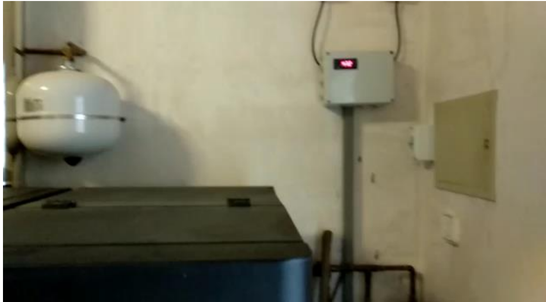
Ruídos anómalos junto da bomba podem tratar ar ou sujidade na bomba e/ou válvula anti-condensação.
