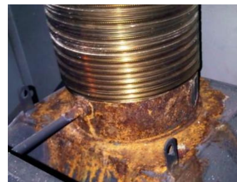
Fig. - Corrosão no Equipamento
