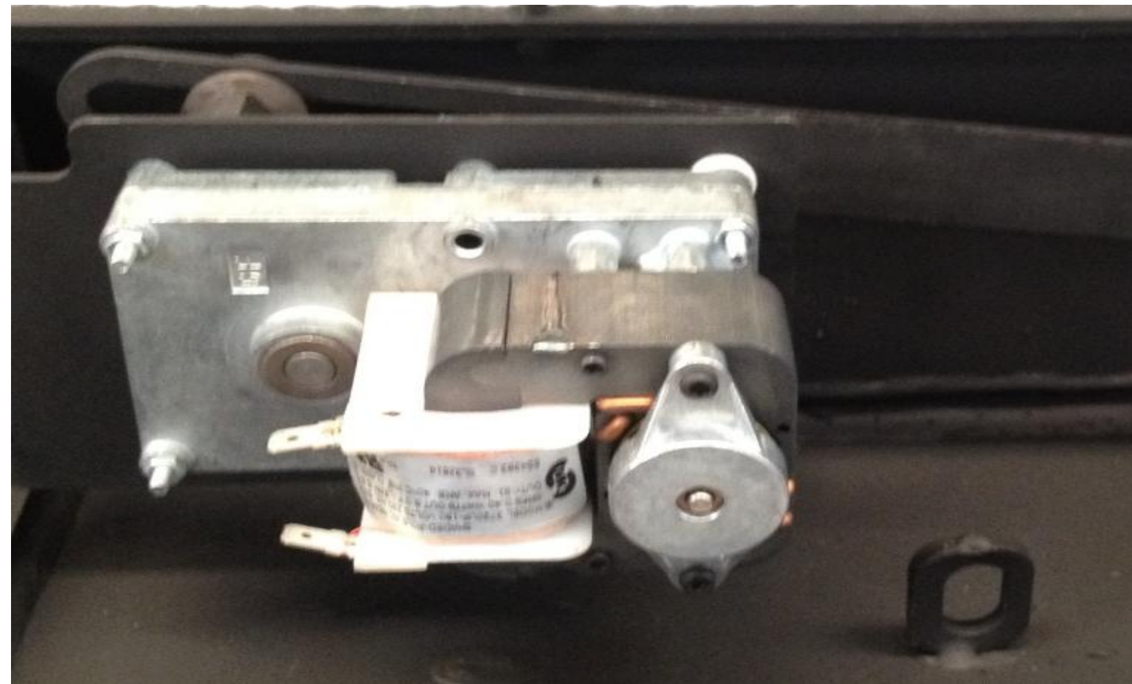
Motor de 5,6 rpm na parte superior da caldeira para a limpeza dos turbuladores.
