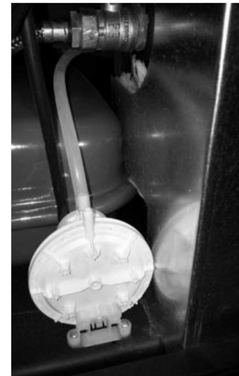
Pressostato em depressão
